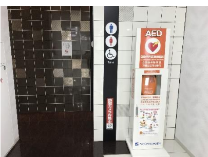
1号館多目的トイレ案内
